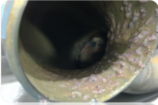
Biofilm in Exhaust Fan
